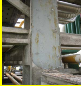
May – Rusaknya pelindung api pada jembatan kolom penunjang pipa
