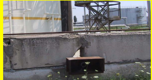
Juni – sebuah lubang pada dinding tanggul tangki
