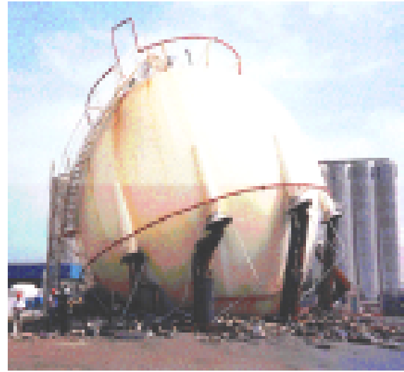
Korosi Menyerang Struktur Penyanggah
